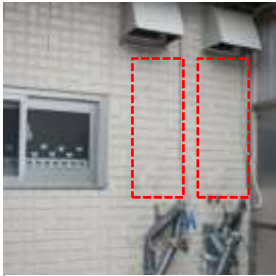
空き家であった家屋。2台の給湯器が盗難被害に遭った（点線赤枠）。
