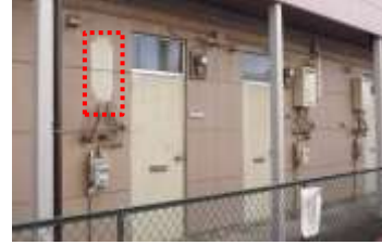
アパートの玄関先。左側が盗難に遭った給湯器設置跡（点線赤枠）。
